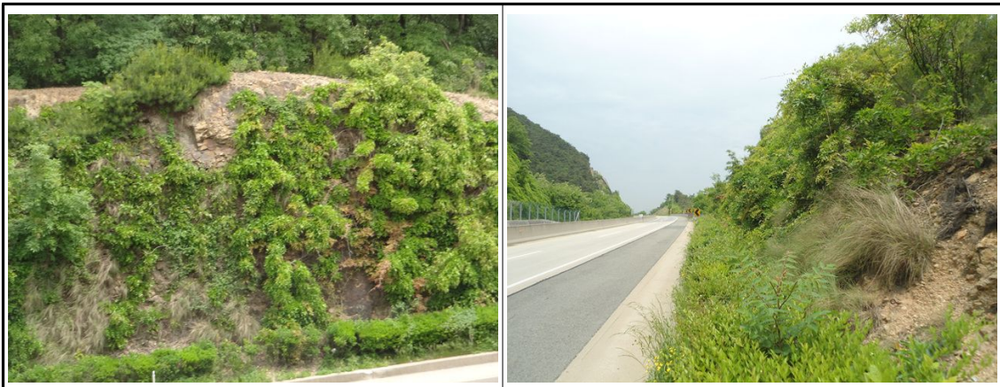
㉠ 81.24~81.30K 1단 심한풍화, 이완암, 낙석위험 ⇨ 주의관찰 후 조치
