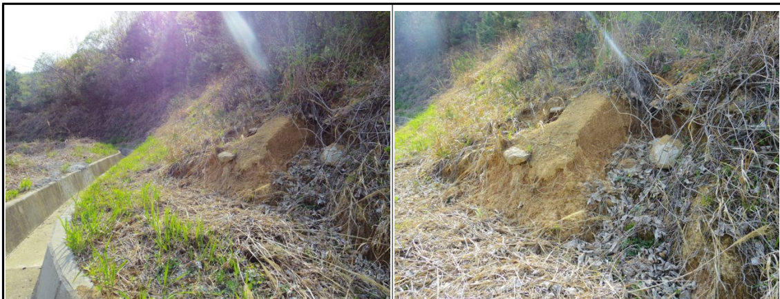
㉠ STA.0+20 상단 표층유실, 세굴 ▷ 주의관찰
