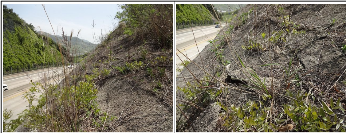
㉠ 66.94K 1단 상부 슛크리트 들뜸 및 파손 ▷ 주의관찰 후 조치
